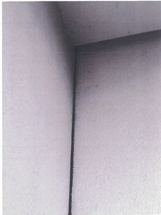
Widok szczeliny pomiędzy warstwami ocieplenia
